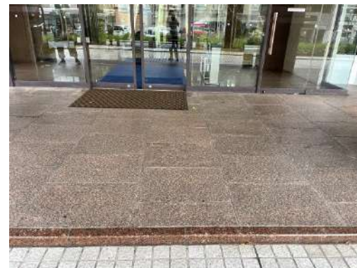
正面入口段差
