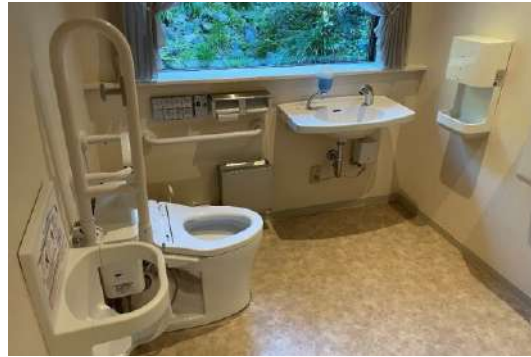
庭園内の多目的トイレ
