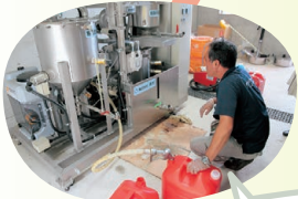
BDFプラント室
